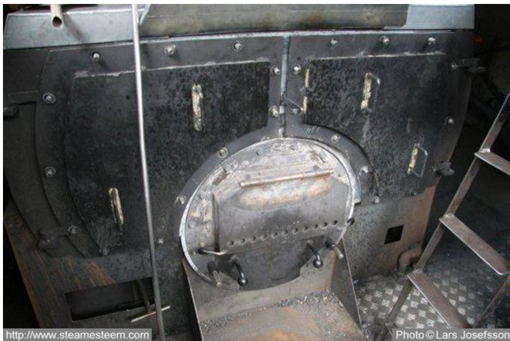
La chaudière au charbon du Hjejlen
