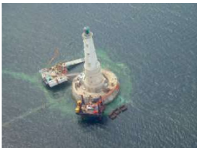
Travaux réalisés dans le cadre du protocole interministériel Mer-Culture au phare de Cordouan
