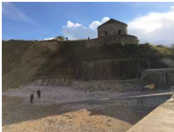
La Tour Vauban de Port-en-Bessin, classée MH, vue de l'Ouest. L'évolution du trait de côte, qui se traduit ici par l'effondrement progressif de la falaise a nécessité de très importantes consolidations.
